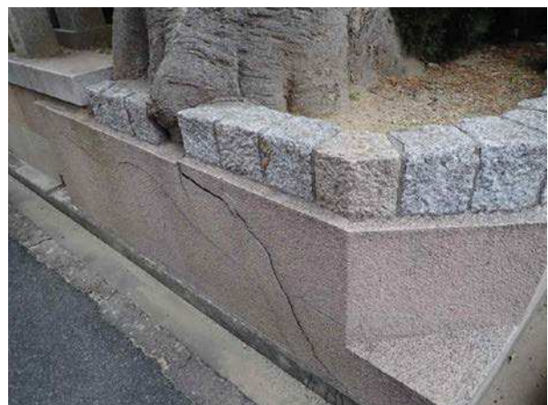
エノキの根元は石とコンクリートに囲まれて、 ひびが入っていました。 171126 撮影 榎元慶子
